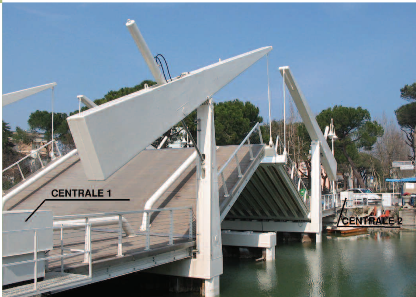
Fig. 7 - Ponte semiaperto con vista delle centraline oleodinamiche.
